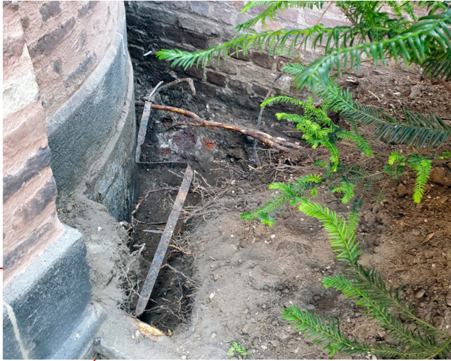
Korrosion an Erdern, unzulässig gelöste Ableitungen
