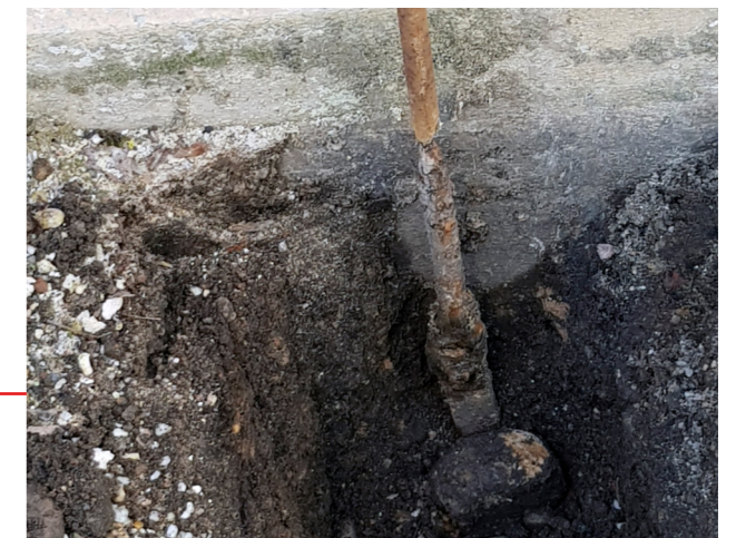
Korrosion an Erdungssystemen
